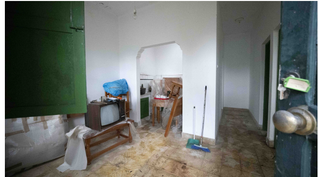
Comedor - humedad visible, suelo danado
