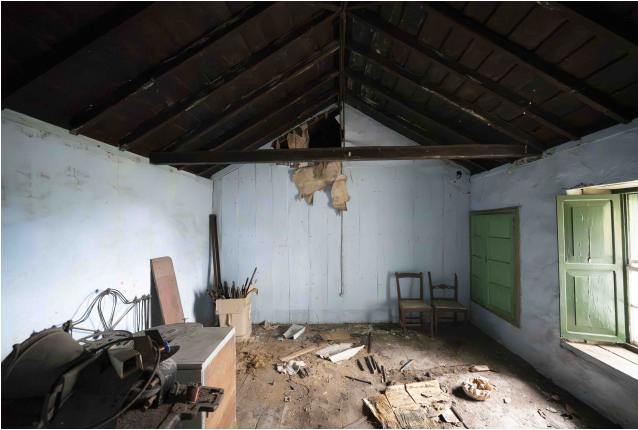
Salon - techo madera, muros deteriorados
