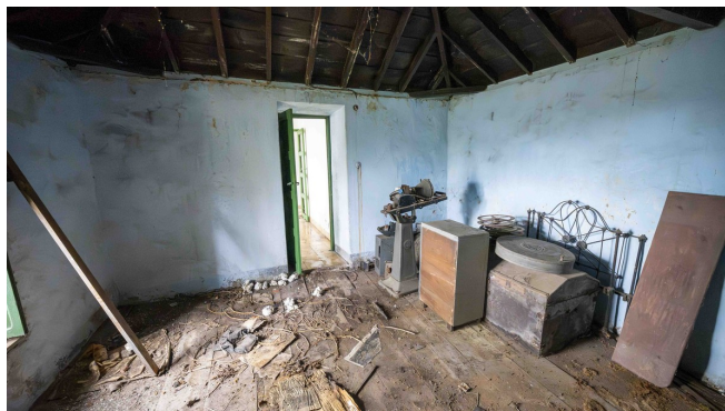
Salon - Vista 2: estado paredes y carpinteria
