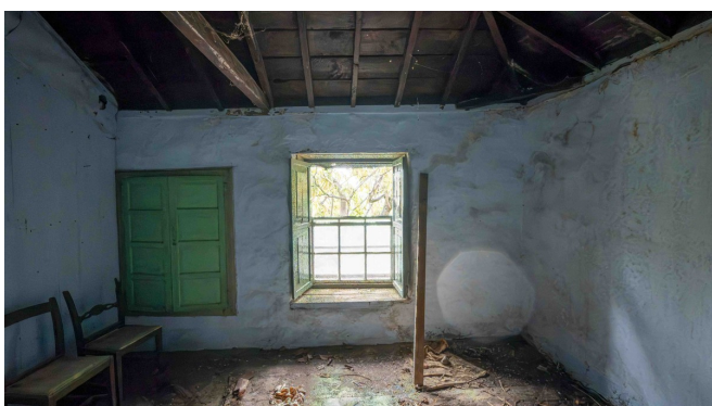
Salon - Vista 3: puertas madera tea, pintura deteriorada
