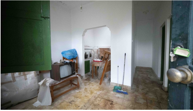
Comedor - vista a cocina, suelo deteriorado, humedad
