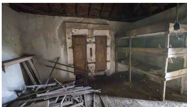
Salon - Pared opuesta: humedad y deterioro
