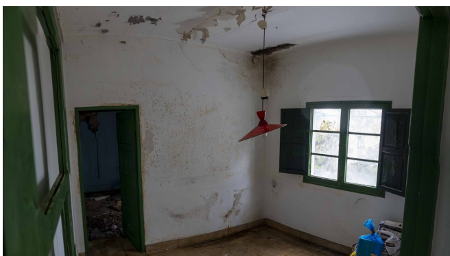
Despacho (7.9 m2) - acabados deteriorados
